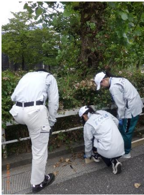
《側溝の穴修繕》
